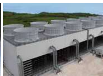
Installations de tours de refroidissement
