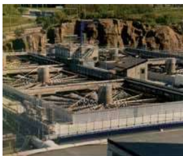
Filtres de nitrification, Göteborg, Suède
