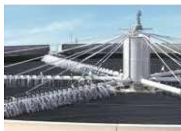
Traitement biologique de l'eau
